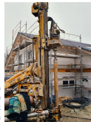
Villa Minergie à Bevaix (NE) chauffée par 2 sondes de 70 m
